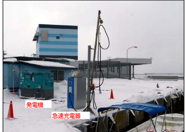
図-3 急速充電器等の設置状況
