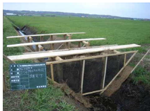
写真-4 汚濁処理施設
